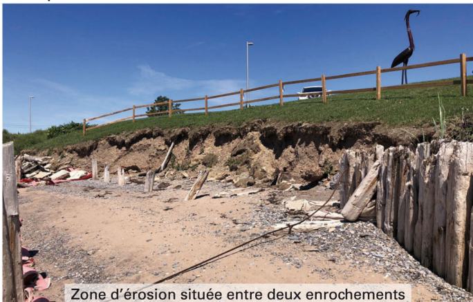
Zone d'érosion située entre deux enrochements
